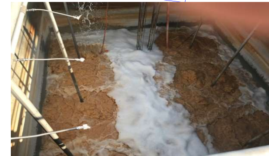
排水処理設備
